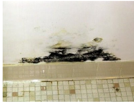
Moho en una pared de baño
