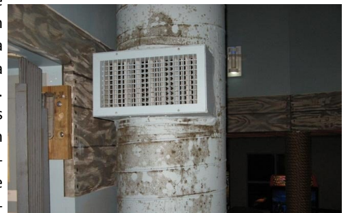
Ducto de ventilación con moho
