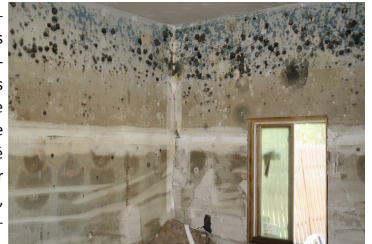
Moho de diversos tipos (colores) afectando una gran área de las paredes de una habitación
